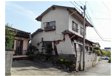
＜地震により被災した住宅＞
