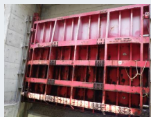
施設の老朽化対策 (甲殿樋門)
