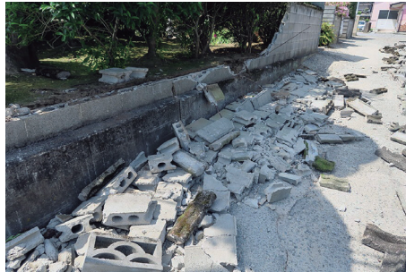
围墙倒塌（提供 防灾系统研究所）
