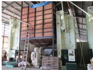
乾燥調整設備
