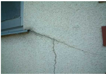
外壁モルタルの亀裂
