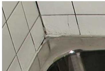
浴室タイルの割れ
