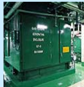
自家発電設備
