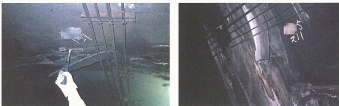
写真 1.10 補修モルタルが劣化してはく離している例（P. 巻末資料 1-17 文献 1) 参照）
