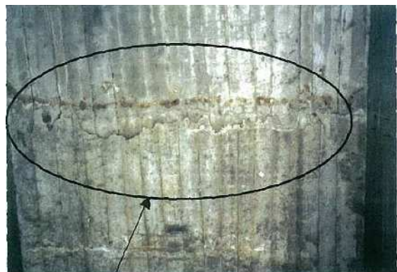
錆汁を伴う床版ひびわれ、遊離石灰が目視できる
