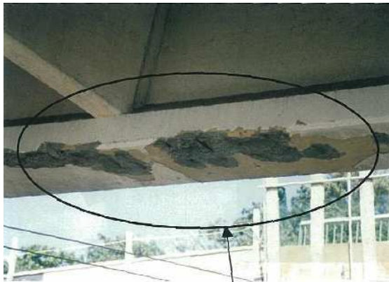
剥離・鉄筋露出が目視できる
