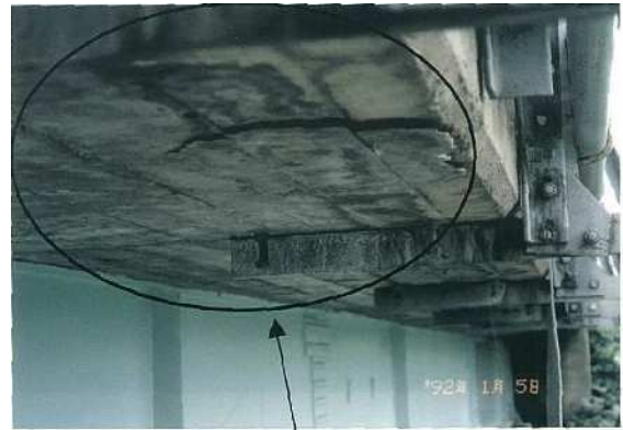
剥離・鉄筋露出が目視できる
