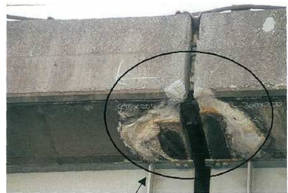
剥離・鉄筋露出が目視できる
