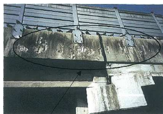
剥離・鉄筋露出が目視できる
