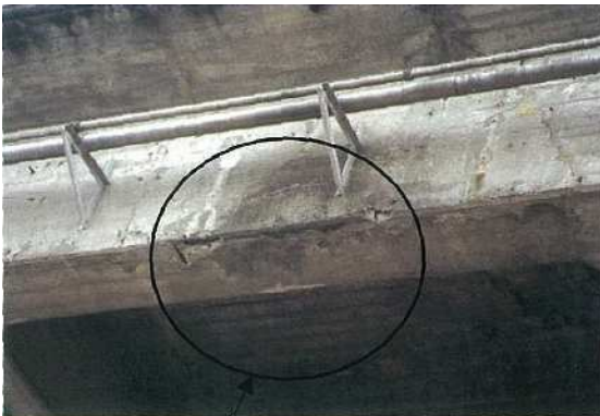
ひびわれ、剥離・鉄筋露出が目視できる
