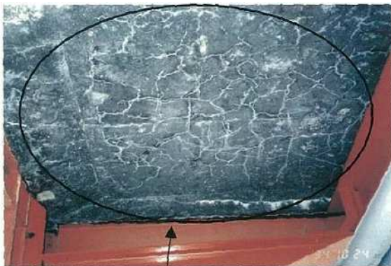
床版ひびわれ、遊離石灰が目視できる
