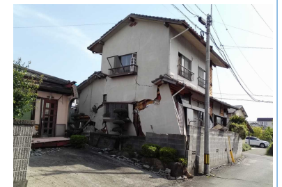
<地震により被災した住宅>
