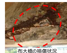
布大橋の損傷状況
