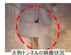
天狗トンネルの損傷状況
