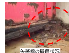
矢筈橋の損傷状況
