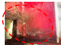
新大森橋の損傷状況
