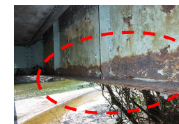
美舞橋の損傷状況
