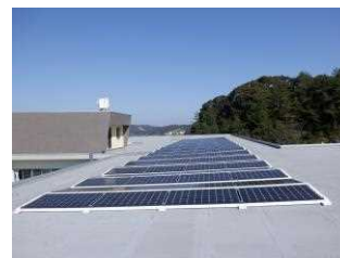
事業所に設置された太陽光発電設備
