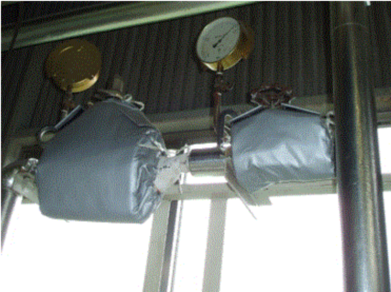
配管・バルブの断熱保温
