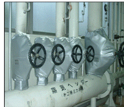
図1 蒸気ヘッダー部バルブの保温状況
