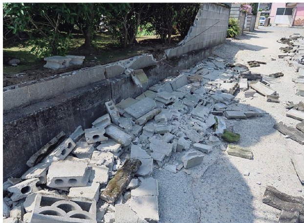
ブロック塀倒壊
