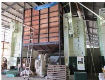
乾燥調整設備
