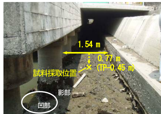
図2 駐車場撤去部の採取位置と標高
