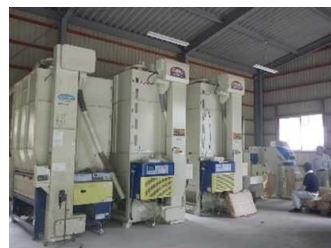
乾燥・調整施設
